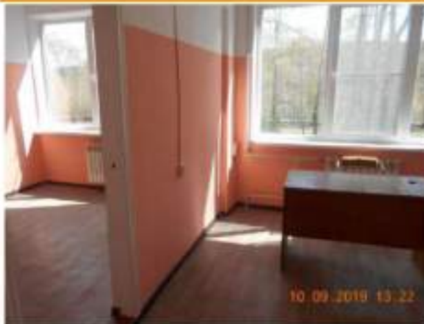
Фотография №2.13. Вид на помещение 2-го этажа, уровень отделки, окна ПВХ, радиаторы отопления
