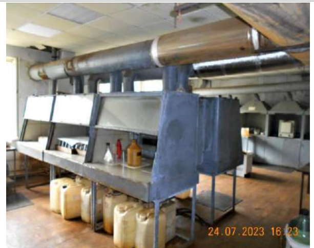
Фотография №2.18. 3-й этаж, рабочее помещение с соответствующим оборудованием
