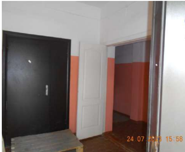
Фотография №2.9. Входная дверь в здание АБК
