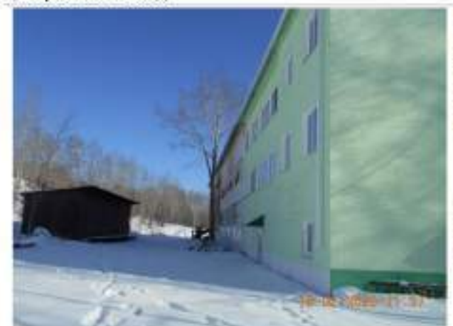
Фотография №2.7. Вид на левую и тыльную стороны АБК, прилегающую территорию, факт производства ремонтных работ
