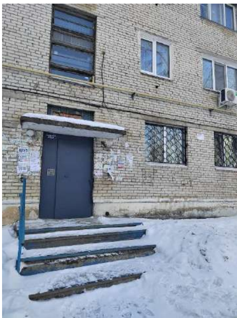
Фото 9. Подъезд, жилой дом
